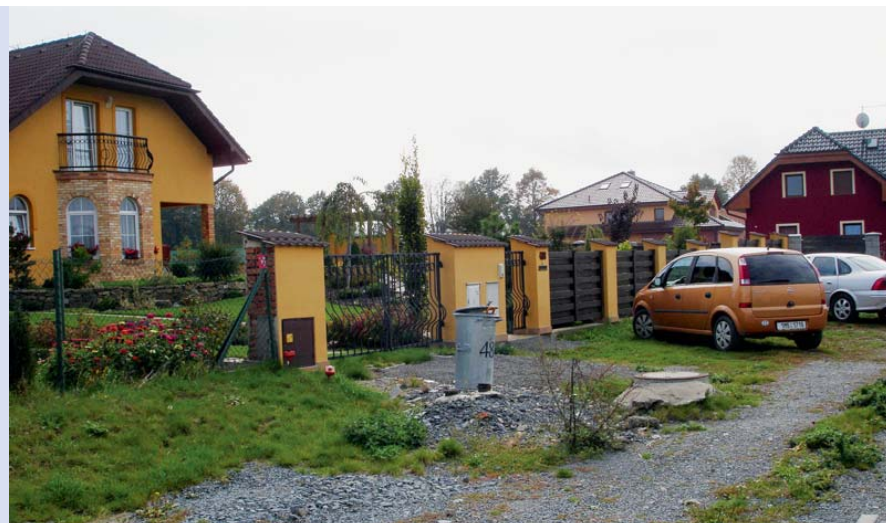
V některých nových čtvrtích domy již dávno stojí, potřebné komunikace však ještě nebyly dokončeny. Výsledkem jsou prашné cesty s vystupujícími hydranty a kanály. Foto: J. Novák (nahore), J. Temelová (dole).
